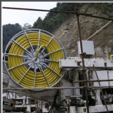
Приводной кабельный барабан на туннелепроходческой машине, Индия
