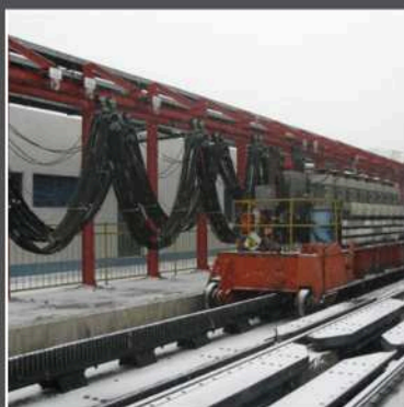
Подвесная система на вагонопрокидывателе, Китай
