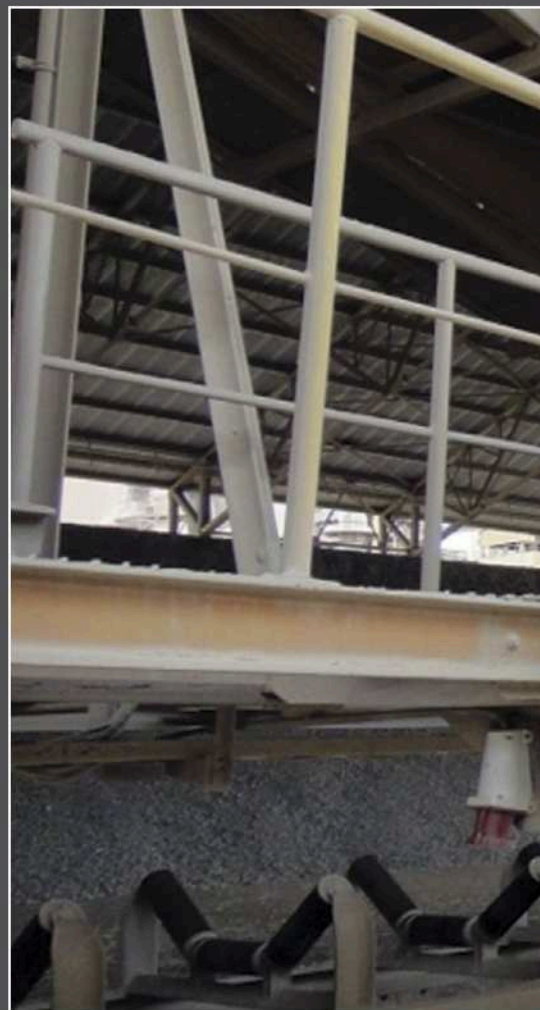
Приводной кабельный барабан на конвейере со сбрасывателем, Венесуэла
