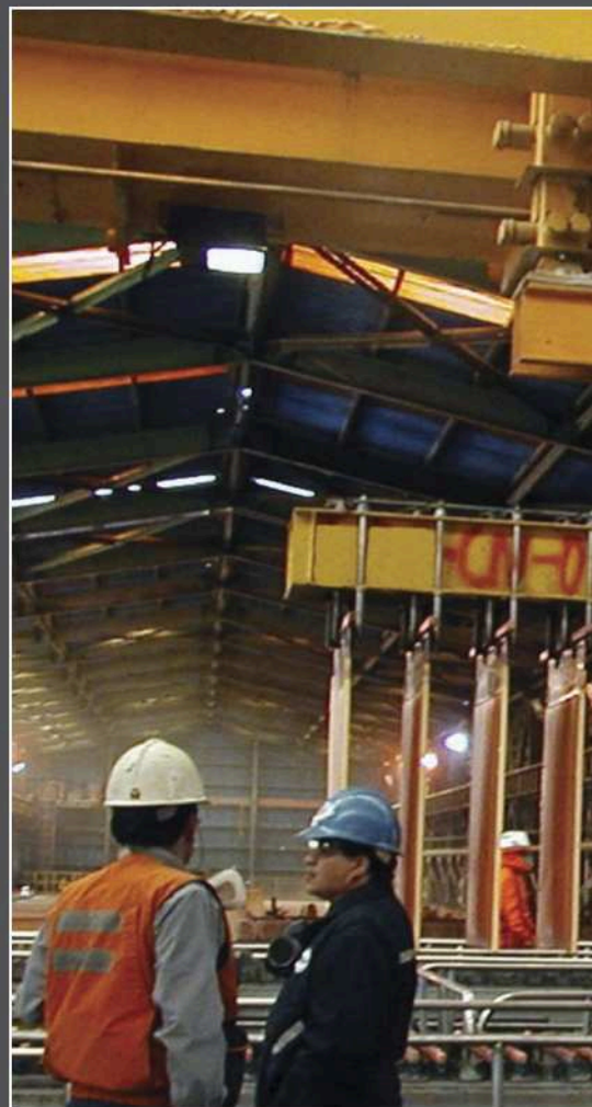
Троллейный шинопровод и подвесная система на процессинговом кране, Чили
