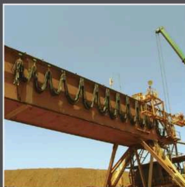
Подвесная система на мостовом перегружателе, Австралия
