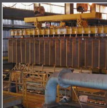
Подвесная система на процессинговом кране электролитического производства, Чили
