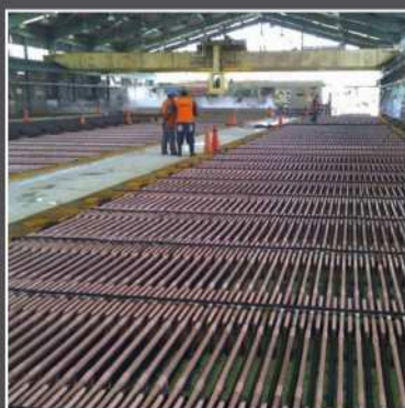
Подвесная система на процессинговом кране электролитического производства, Перу
