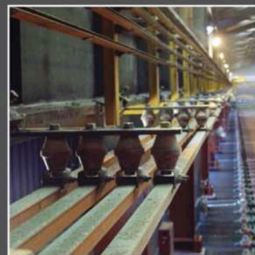
Троллейные шинопроводы с защитой "Dura Coat" на процессинговом кране электролитического производства, Чили
