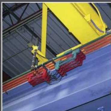
Шинопровод на обслуживающем кране, Китай
