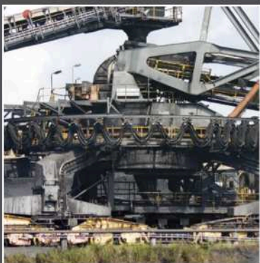
Подвесная кабельная система на Стакере/Реклеймере, Австралия
