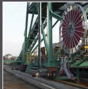
Приводной кабельный барaban На Стакере/Реклеймере, Тайланд
