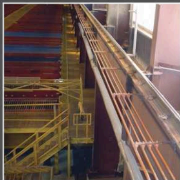
Троллейные шинопроводы с защитой “Dura Coat” на процессинговом кране электролитического производства, Чили
