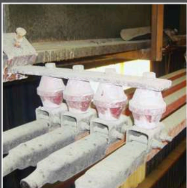
“Троллейные шинопроводы с защитой Dura Coat” на процессинговом кране электролитического производства, Чили
